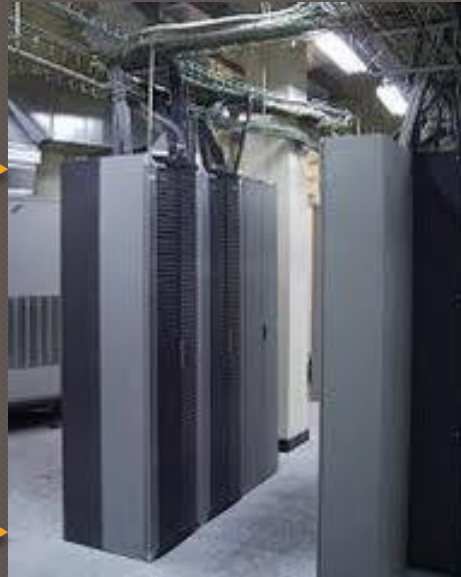
Equipos de conmutación
