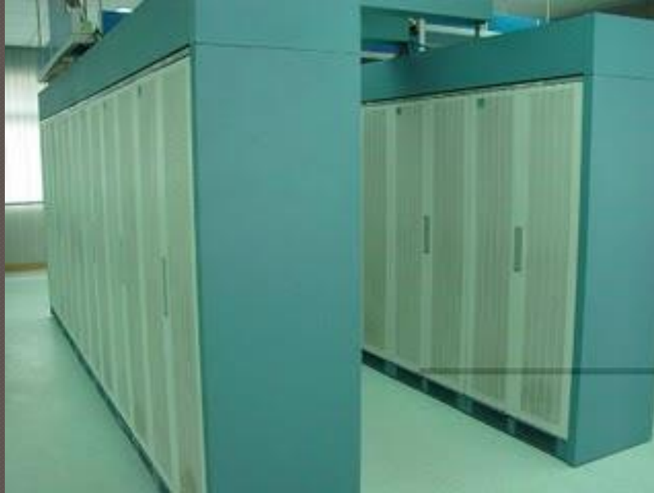
Sala de conmutación . Sistema 5ESS de Lucent Technologies
