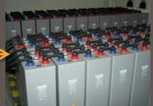
Sala de baterías 48 Vcc
